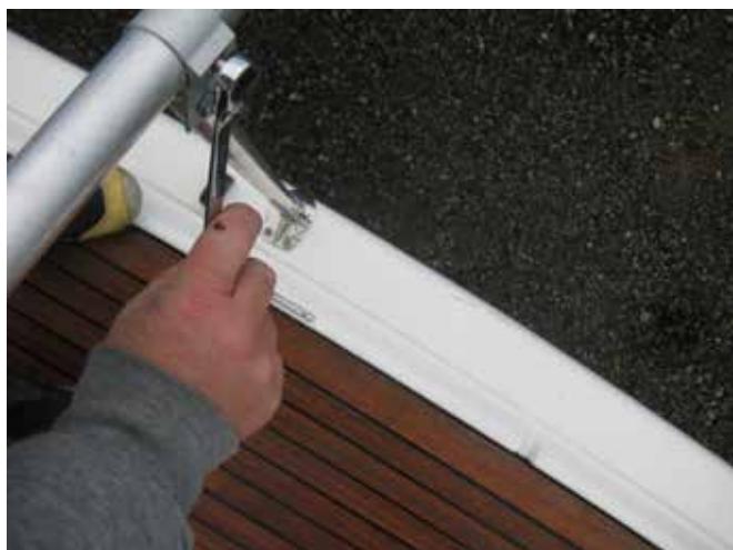
Spær monteres og spændes ved septer. Bor evt. styrehul i rør til 8 mm bolt.
